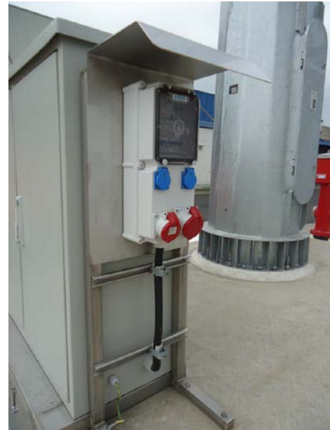
Bild 6: Steckdosenkombination an Mastverteiler
